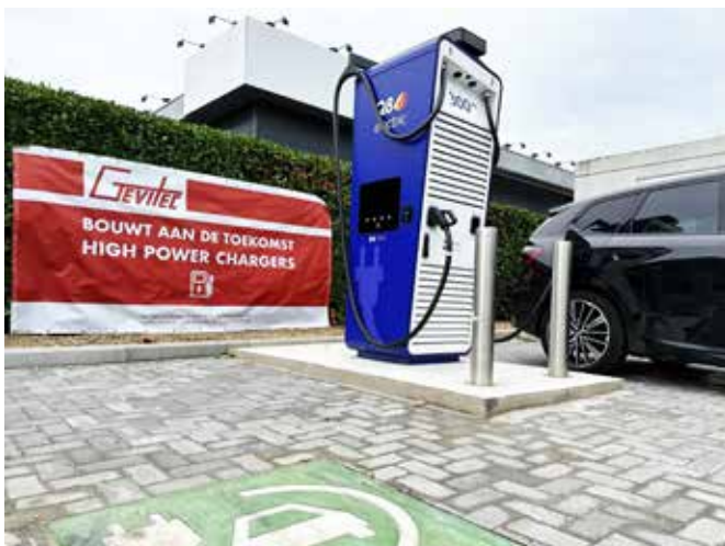
Hoogspanning nodig? Gevitec checkt, installeert en sluit aan.
